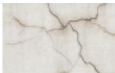
Figura 2. Fissuras e trincas.
